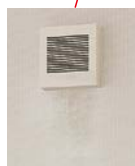
壁換気だと壁面に汚れが…。
